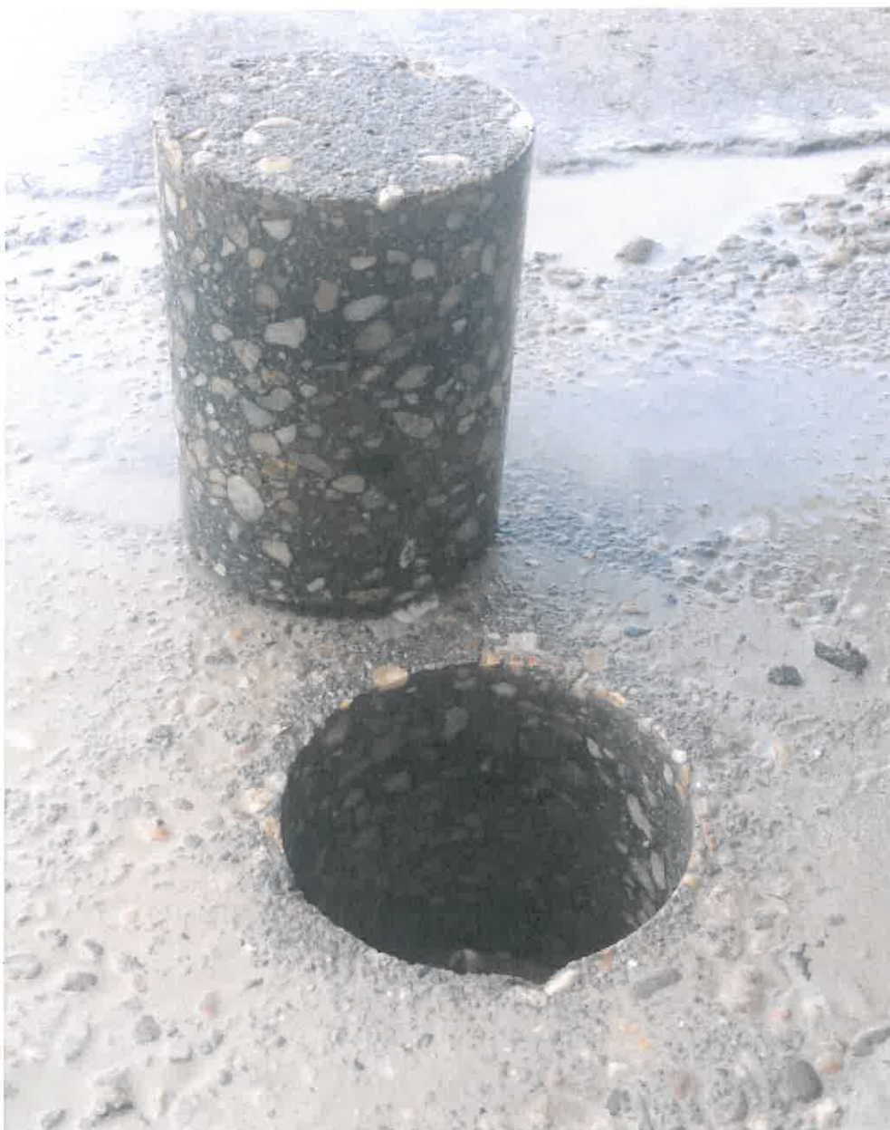
1. kép: Fúrást követően Nyíregyháza, Tó utca 0+200 km. sz. jobb oldal sávközép nyomvonal helyreállítás
